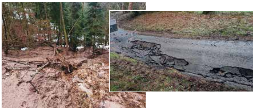
Quelques photos des dégâts occasionnés ces derniers jours par la fonte de la neige et les fortes pluies au-dessus de Rupt et à Grandrupt.
